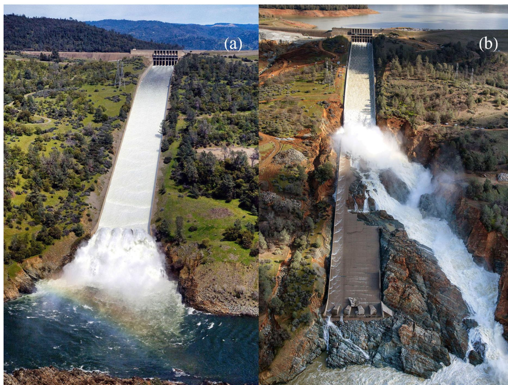
Figure 5.53 – Évacuateur de crue du barrage d'Oroville (Californie) avant (a) et après (b) la crue de février 2017. Source : California Department of Water Resources .
