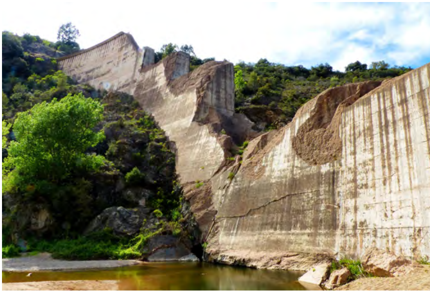
Figure 3.15 – Brèche dans la voûte du barrage de Malpasset. Source : wikimedia .
