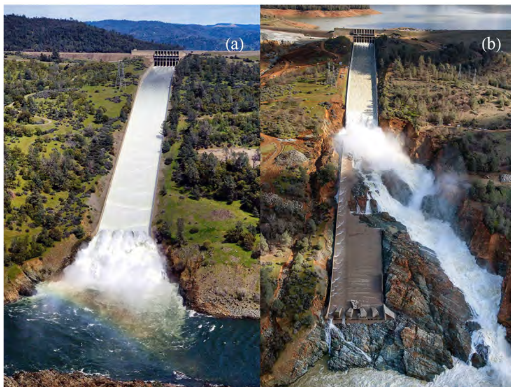
Figure 5.53 – Évacuateur de crue du barrage d'Oroville (Californie) avant (a) et après (b) la crue de février 2017. Source : California Department of Water Resources .
